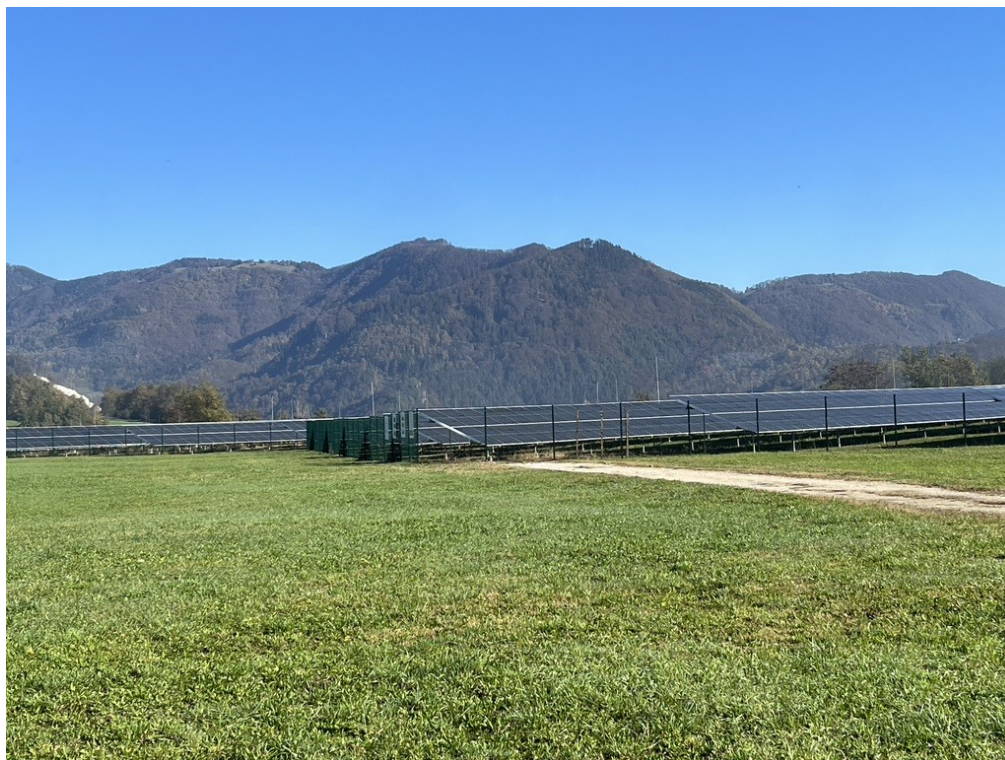
Slika 17: Prikaz obstoječe sončne elektrarne SEP1 (pogled iz območja predvidenega plana proti severovzhodu)
